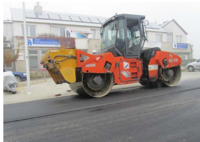
▲ Droga do Domu Małego Księcia
